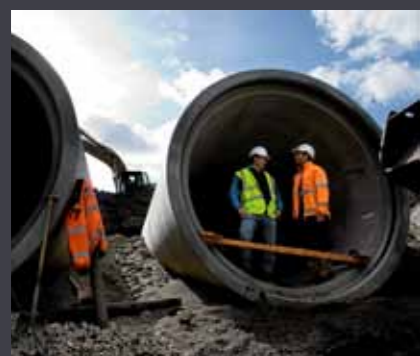
Underjordisk regnvandsbassin Foto: Aarsleff
